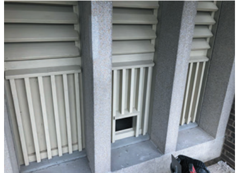
Das Einflugloch in der Schallluke für die Turmfalken
